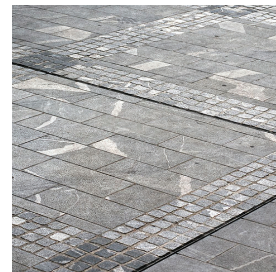
ŽULOVÁ DLAŽBA Z TMAVÝCH KOSTEK hlavní plocha náměstí - 2 různé formáty a odstíny
